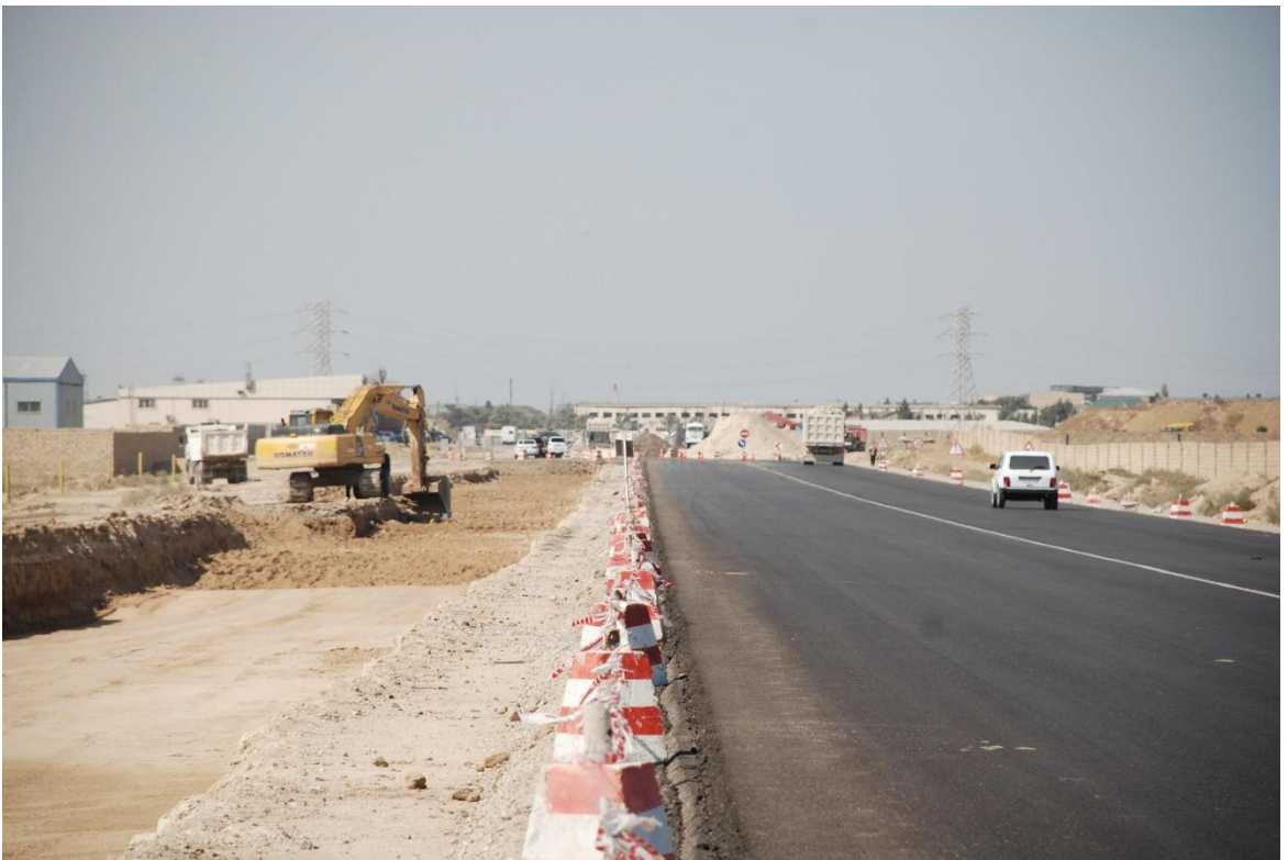
Şəkil 8. Qala-Pirallahı avtomobil yolunda yararsız qrunտun çıxarılması və əhəngdaşı materialı ilə əvəz olunması.
