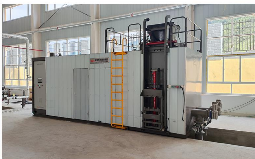
Şəkil 13. “Maqna” qaz təmizləmə sistemi.
